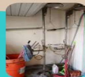
圖2.緊急沖淋裝置擺放雜物且未維護
